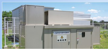
【 非常用自家発電設備 】
